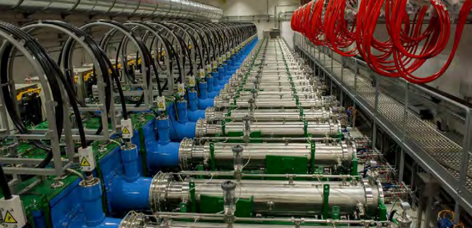
Figure 4. Machine de radiographie éclair de l'installation Epure, sur le Centre CEA - Valduc.
